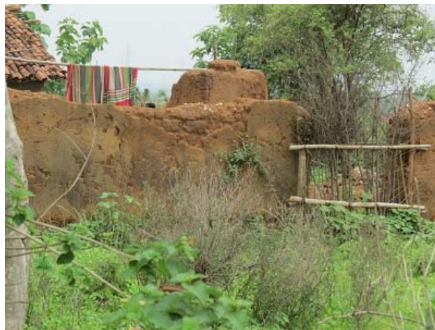
写真 2：発破作業で破損した土壁（2015 年 7 月）
